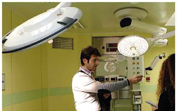
Le lampade e la strumentazione in una delle nuove sale operatorie
